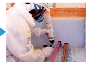
fig.14 浴室などの配管まわり
